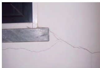
FISSURAS NO INTERIOR DA HABITAÇÃO
