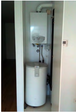
CONJUNTO DE ESQUENTADOR E DEPÓSITO DE ÁGUA INDIVIDUAL DE CADA FOGO
