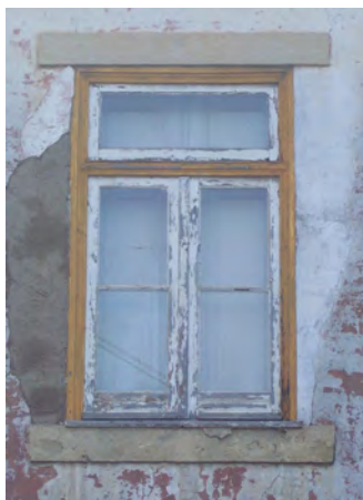
FALTA DE MANUTENÇÃO
