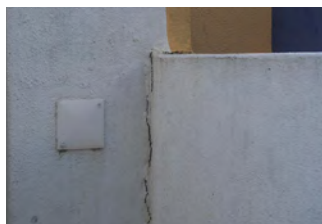
FENDA NO EXTERIOR DA HABITAÇÃO
