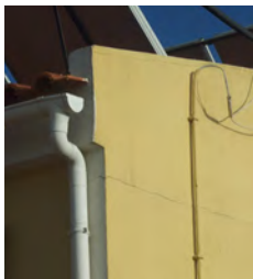
OBSTRUÇÃO DE CALEIRAS
