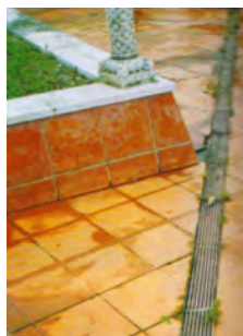
IRREGULARIDADES NO PAVIMENTO
