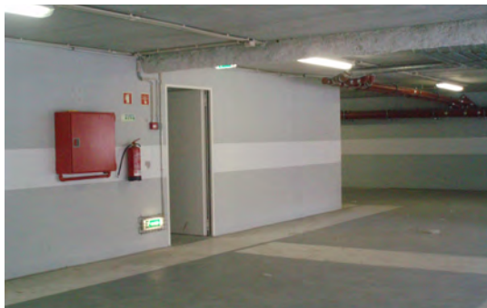
ILUMINAÇÃO DE CAMINHO DE FUGA
