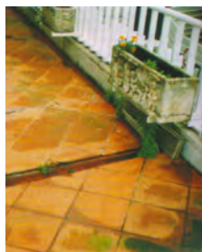
OBSTRUÇÃO DE ÁGUAS
