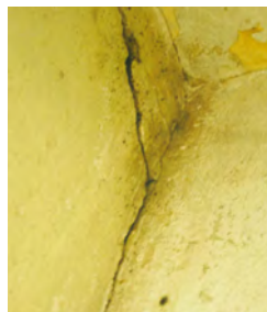
FALTA DE REPARAÇÃO DO ESTUQUE
