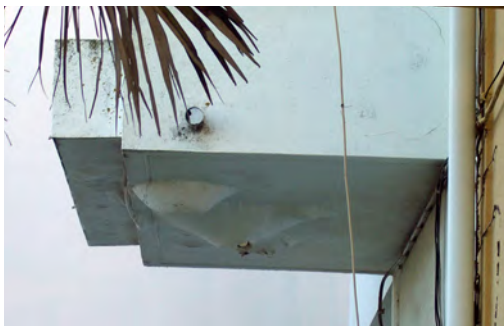
DESPRENDIMENTO E FALTA DE ADERÊNCIA
