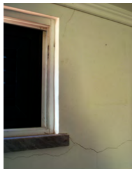
FISSURA NA PAREDE
