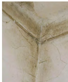
PAREDE COM SINAIS DE HUMIDADE
