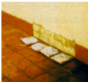
CERÂMICOS SOLTOS PARA SUBSTITUIÇÃO DE BETUME E REFECHAMENTO DA JUNTA
