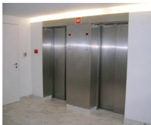
ELEVADORES DE PASSAGEIROS
