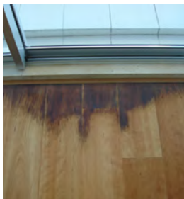
PARQUETE COM PRESENÇA DE HUMIDADE
