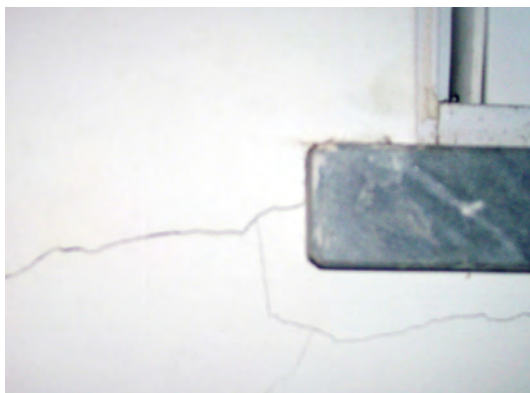
FISSURAS NO ESTUQUE
