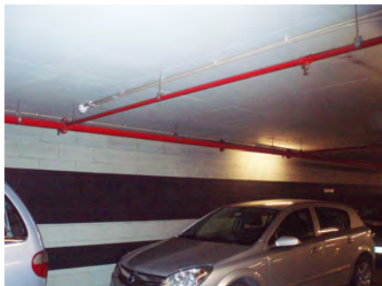
REDE DE SPRINKLERS
